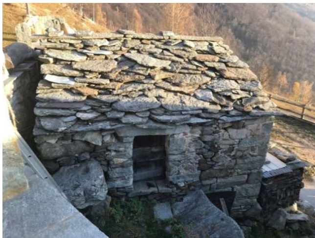
Figura 3: posa a spacco
