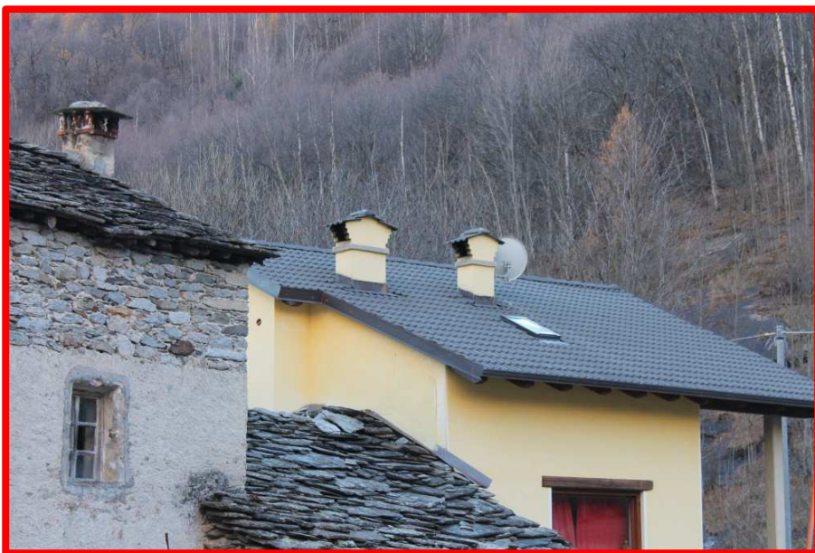
Figura 26: manto in laterocemento e comignoli intonacati sconsigliato
