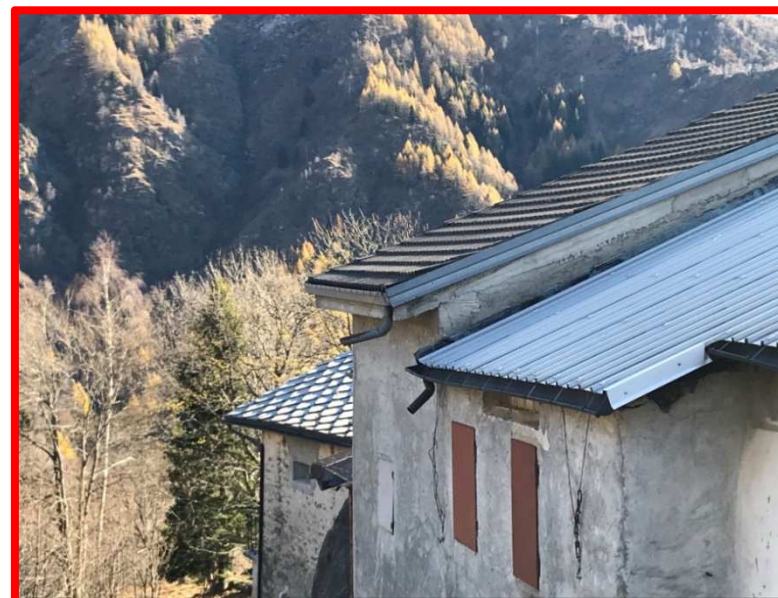
Figura 25: manto in lamiera grecata sconsigliato
