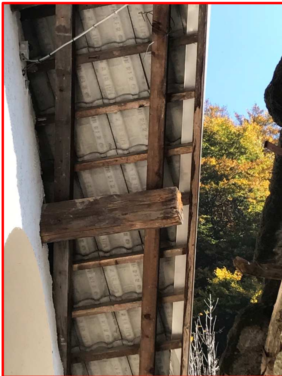
Figura 23: manto in laterocemento sconsigliato
