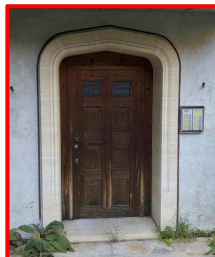
Figura 64 disegno non conforme alla tradizione costruttiva
