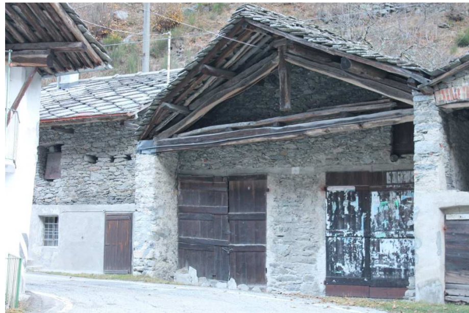
Figura 10: sporto del tetto realizzato con capriata – Frazione Frera Inferiore tra Locana e Noasca
