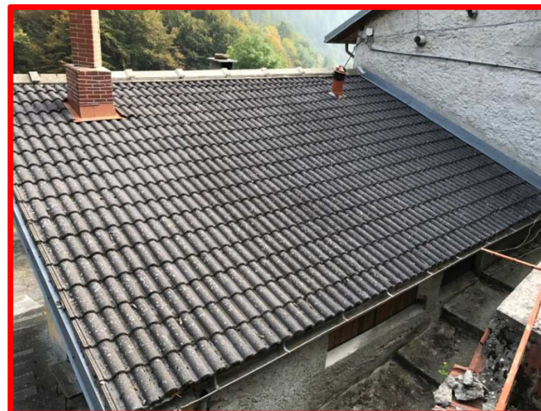
Figura 24: manto in laterocemento sconsigliato
